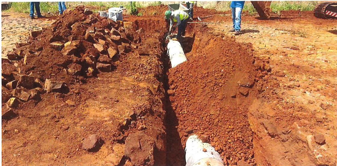
Foto 01: Rede de drenagem Rua Lídio Oltramari.
