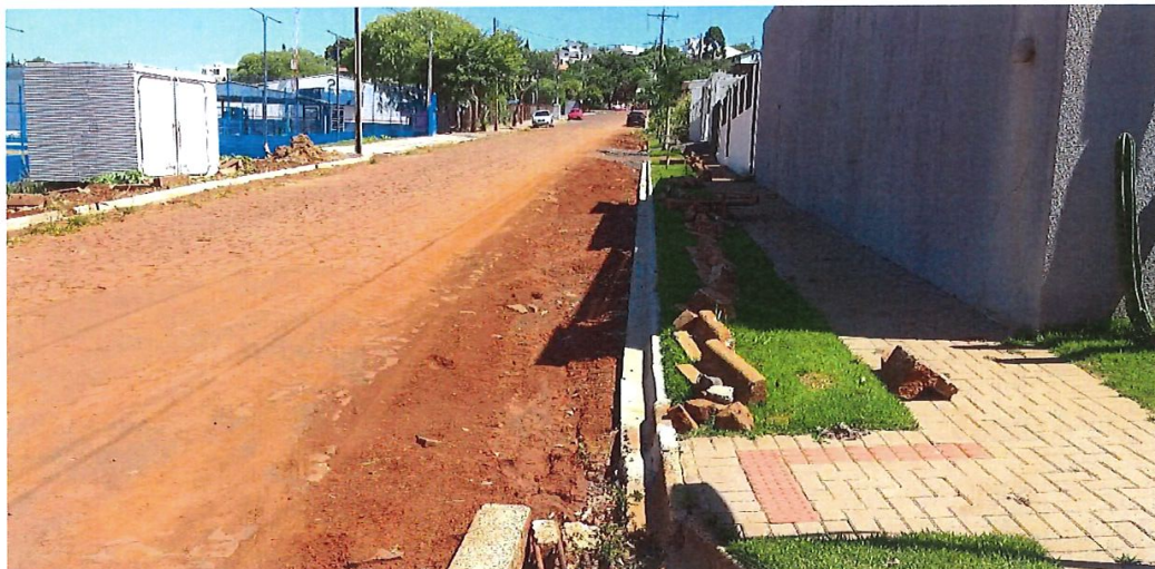
Foto 07: Rua Silva Jardim – Meio-fio
