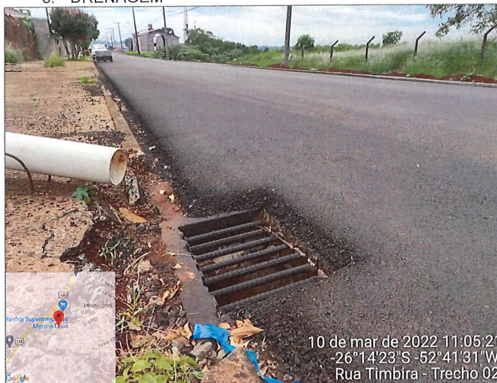
Imagem 18: Boca de lobo
