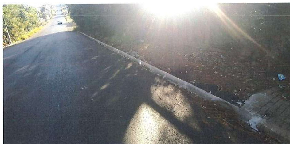
Foto 57: Rua José Fraron – meio fio
