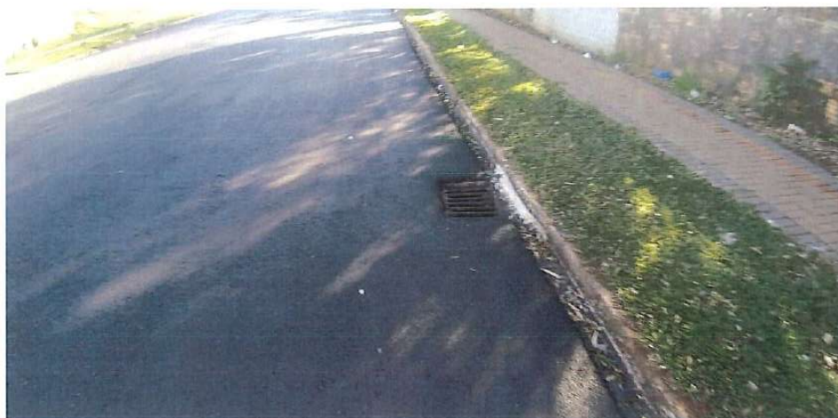
Foto 58: Rua José Fraron – drenagem
