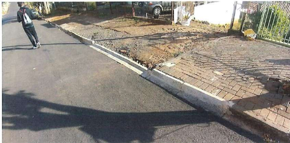
Foto 49: Rua Pedro José da Silva (Trecho 01) – meio fio
