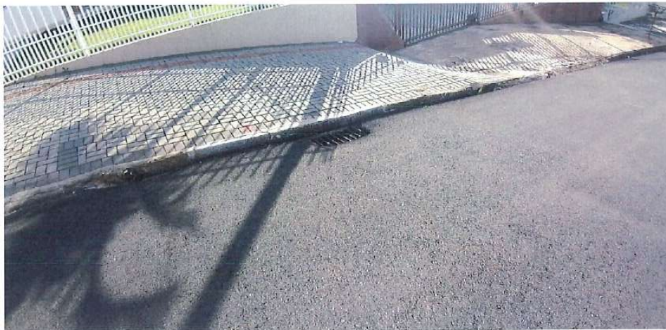
Foto 52: Rua Pedro José da Silva (Trecho 01) – drenagem
