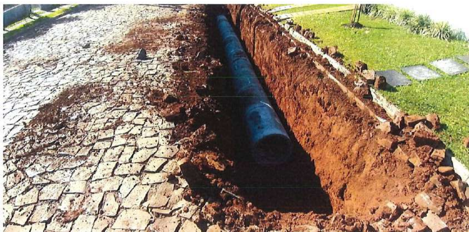
Foto 67: Rua Theóphilo Petrycoski – drenagem
