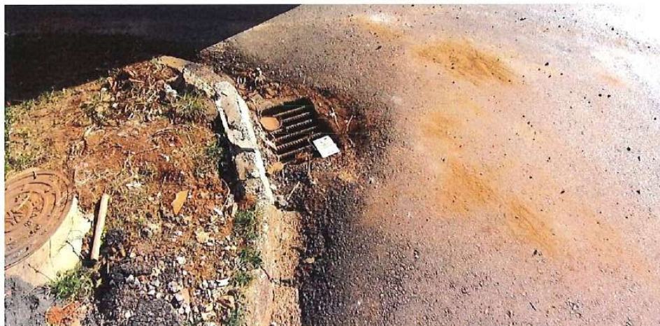
Foto 07: Rua da República - drenagem
