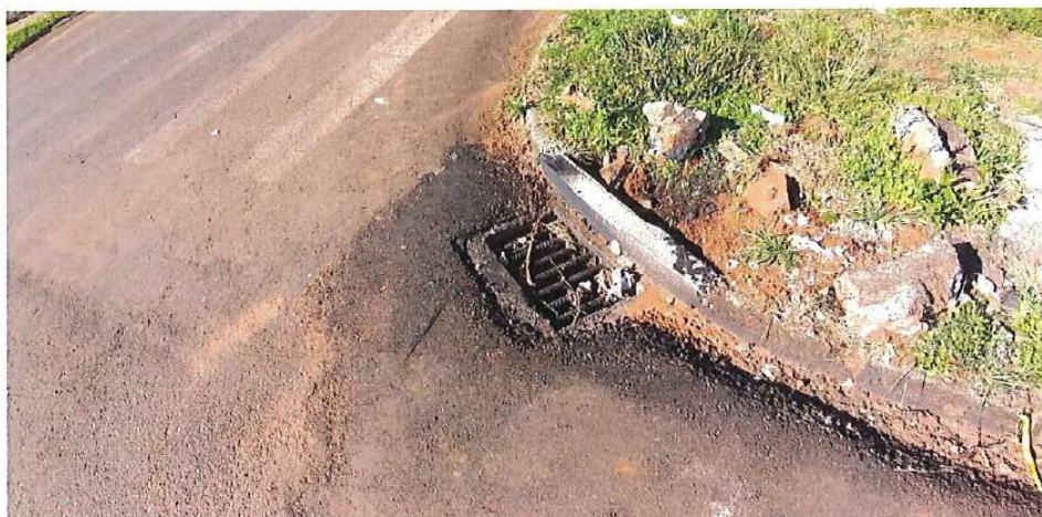
Foto 11: Rua Papa João XXIII – drenagem
