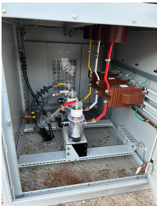
Figura 5 – Visão posterior - disjuntor geral em alta tensão.
