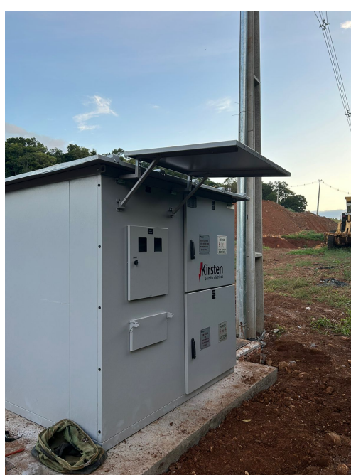
Figura 4 – Cabine primária de medição – Vista frontal.
