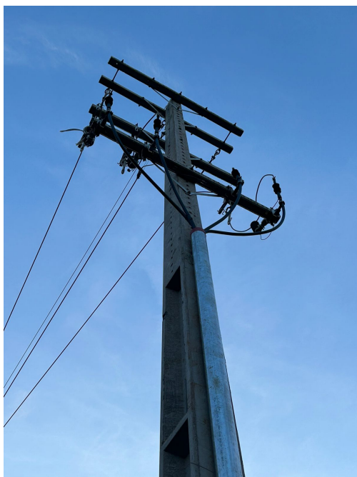
Figura 1 – Poste de Entrada da Medição.
