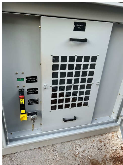
Figura 6 – Visão frontal - disjuntor geral em alta tensão
