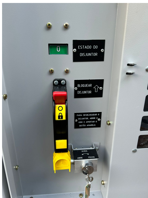
Figura 7 – Detalhe proteção do disjuntor em alta tensão.
