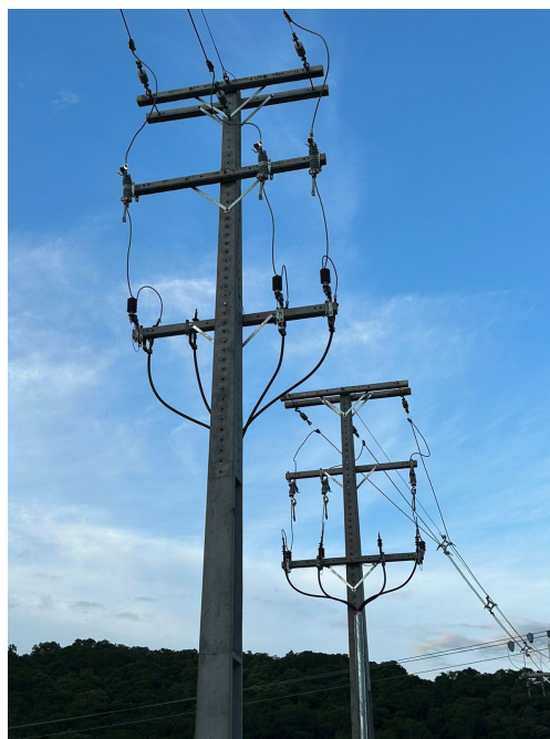
Figura 2 – Poste de Entrada e saída da Medição
