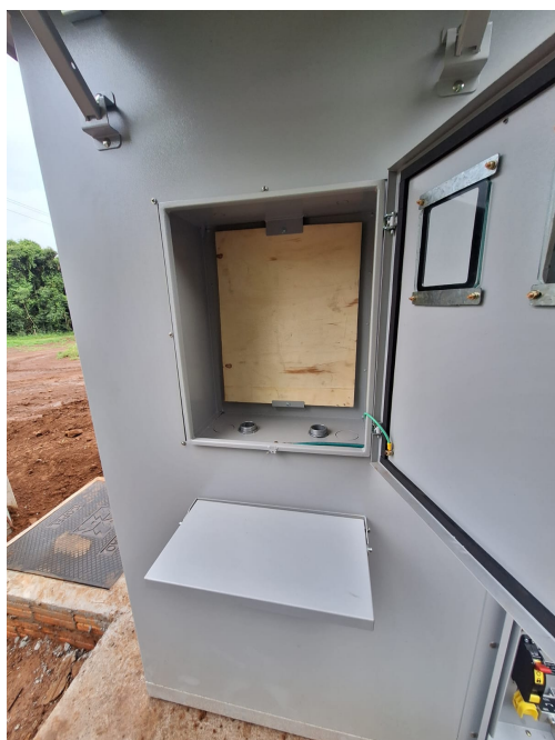
Figura 15: Espaço para instalação do medidor Copel.
