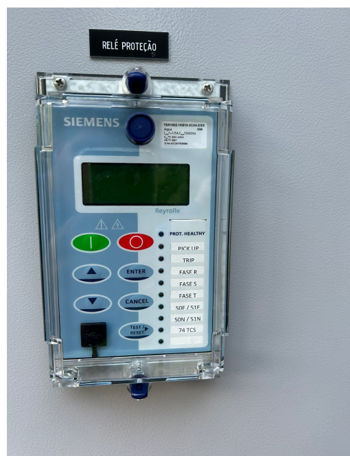
Figura 11 – Relé de proteção da chave seccionadora.
