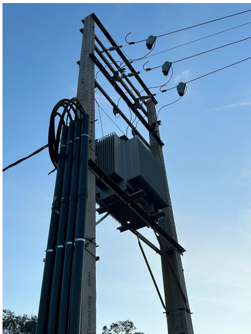
Figura 17: Estrutura para armazenar o transformador.
