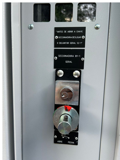
Figura 12: Acionamento – Chave seccionadora.
