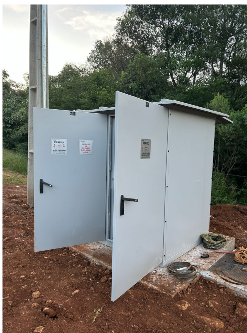
Figura 3 – Cabine primária de medição – Vista Posterior.
