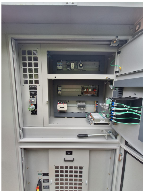
Figura 13: Quadro elétrico – Chave Seccionadora.
