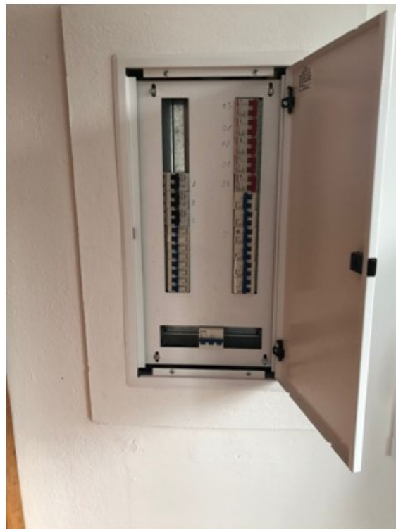
Foto 2: Quadro de energia elétrica (disjuntores).
