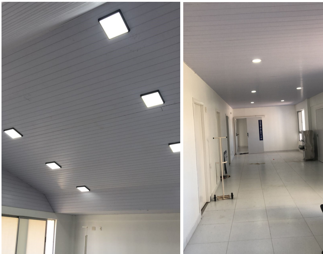
Foto 5: Luminárias/ Forro de PVC.
