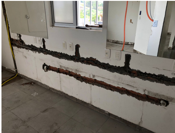
Foto 4: Pontos de hidráulica e elétrica.
