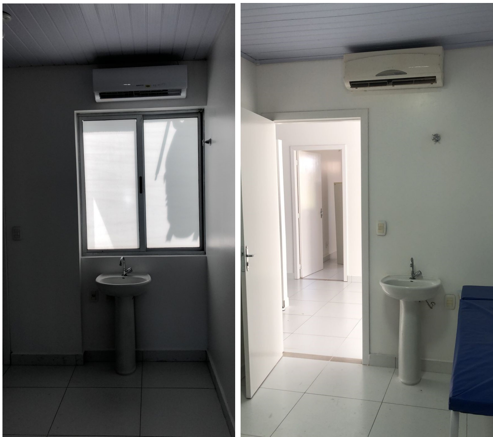
Foto 7: Pontos de ar condicionado.
