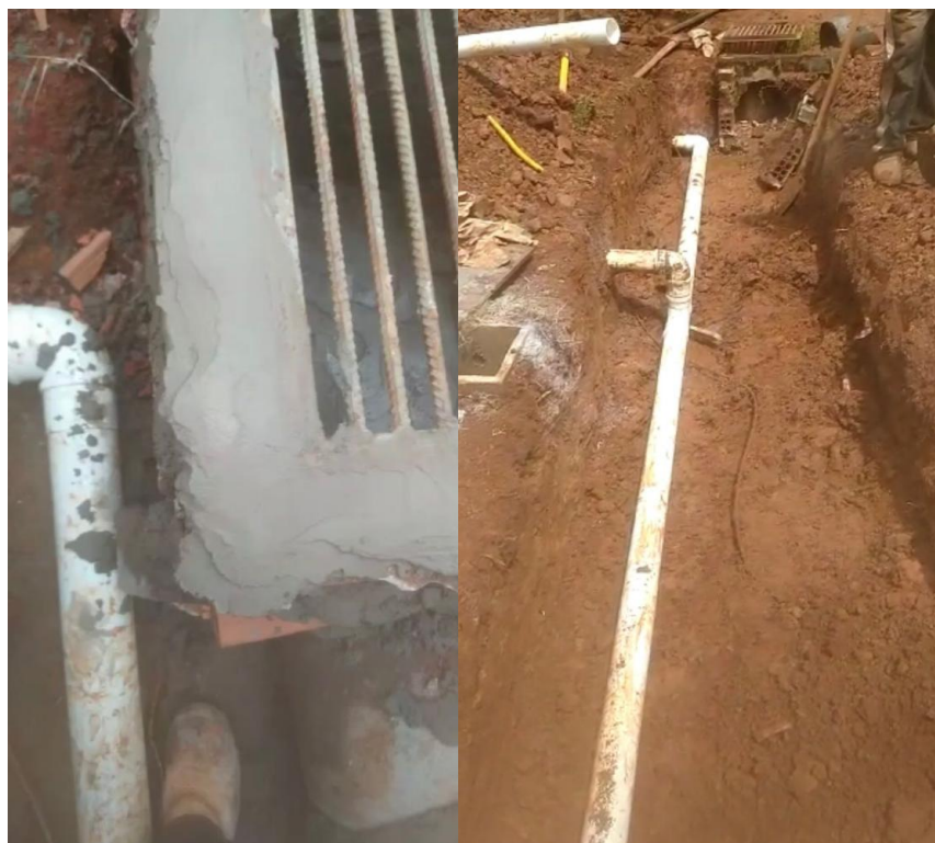
Foto 5: Redirecionamento e correção de esgoto com ligação irregular
