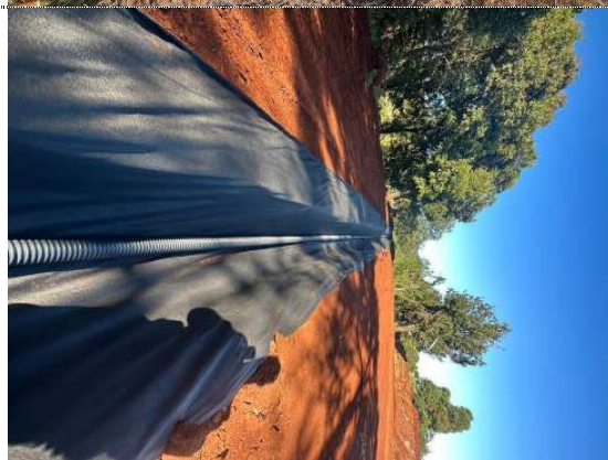
8 – Dreno Tubulação de PVC DN 100
