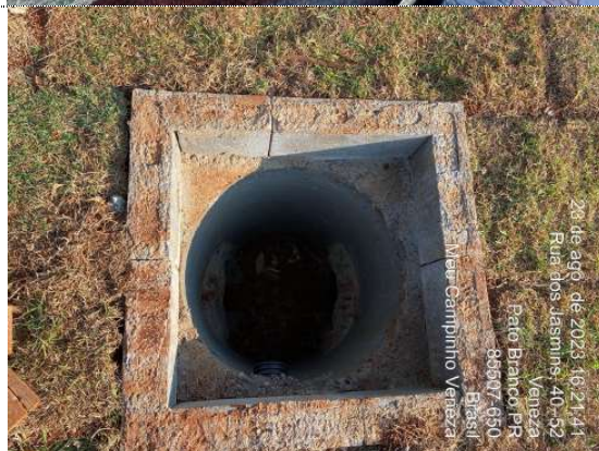
7 – Caixa de Passagem
