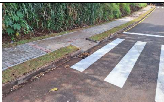
CALÇADAS RUA JOÃO LORA (FOTO 18)
