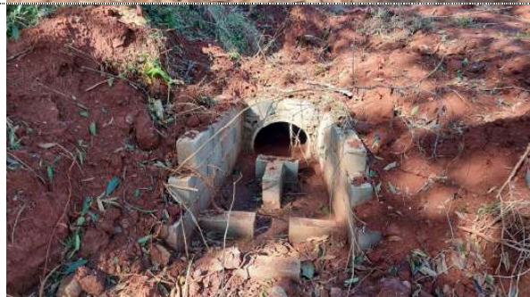
Fotografia 18: Drenagem Rua Marília – Dissipador.
