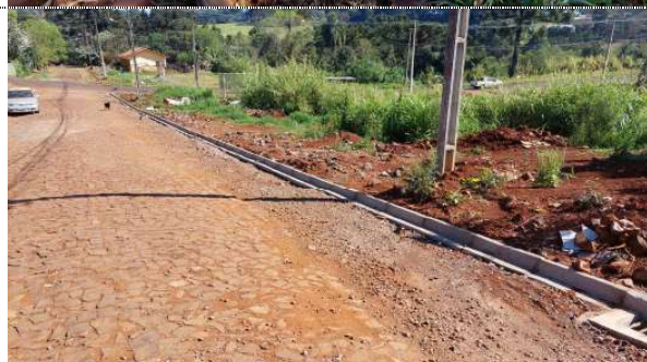
Fotografia 10: Meio Fio Rua Celeste Mocelin.
