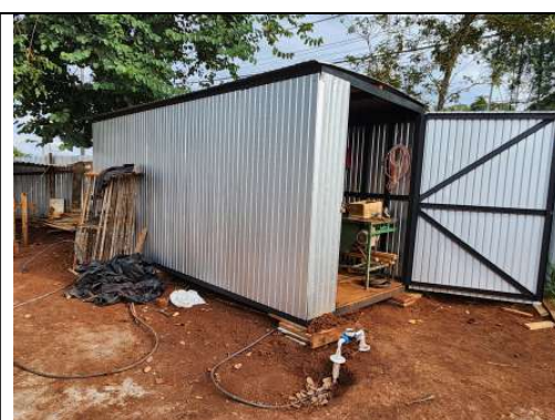
F10: ENTRADA DE ÁGUA, CONTAINER
