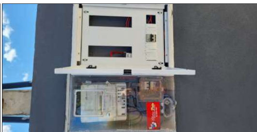
5 | entrada de energia
