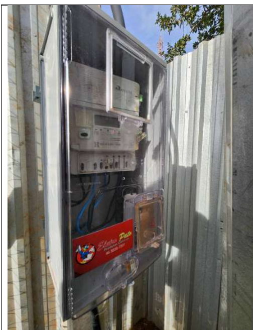
F4: MEDIDOR DE ENTRADA DE ENERGIA
