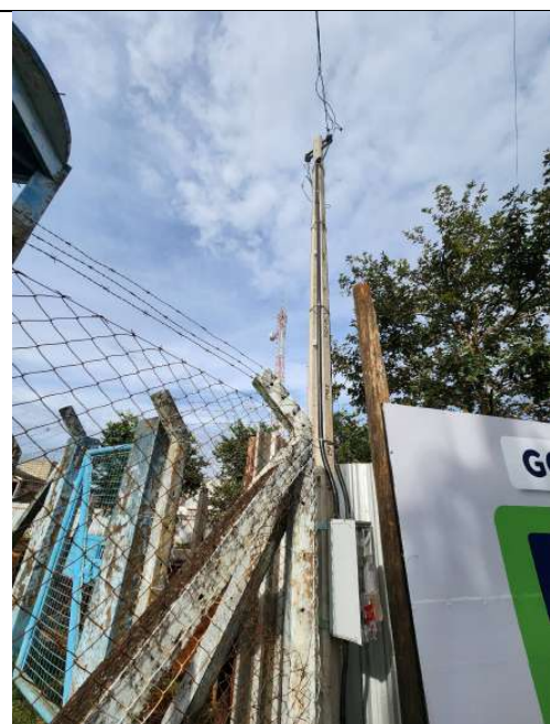
F3: POSTE DE ENTRADA DE ENERGIA
