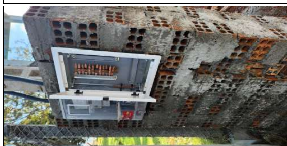
10 | mureta da entrada de energia, quadro de entrada de energia
