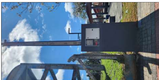
4 | entrada de energia, quadro geral, mureta
