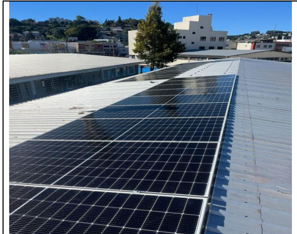
PAINEL SOLAR EM FASE FINAL (ESCOLA ROCHA POMBO)
