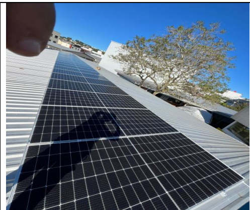
PAINEL SOLAR INSTALADOS (ESCOLA ROCHA POMBO)
