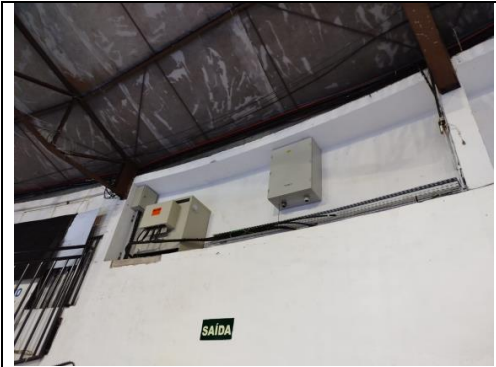
QUADRO DE DISJUNTOR E TRANSFORMADOR (GINASIO DOLIVAR LAVARDA)
