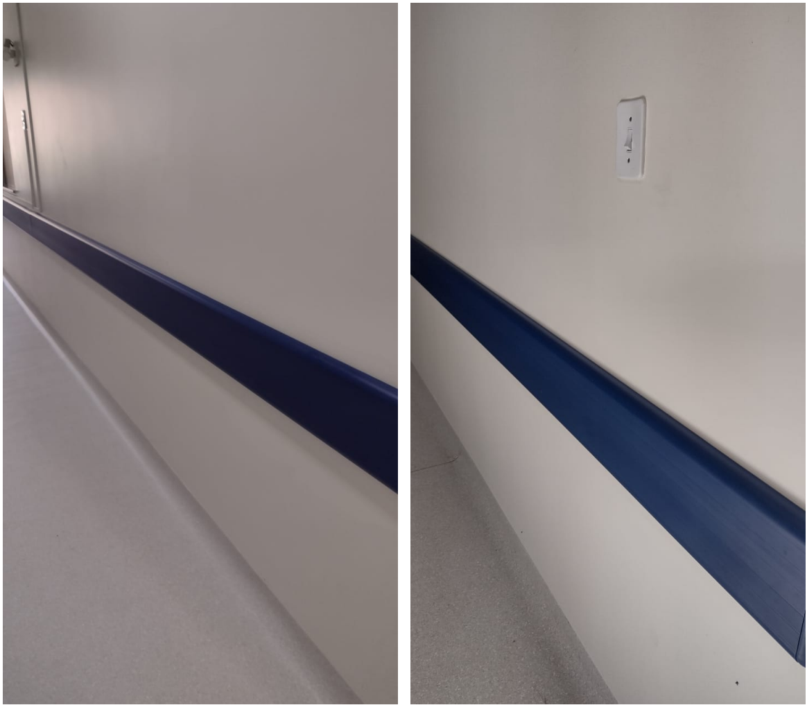
Foto 3: Bate maca instalado
