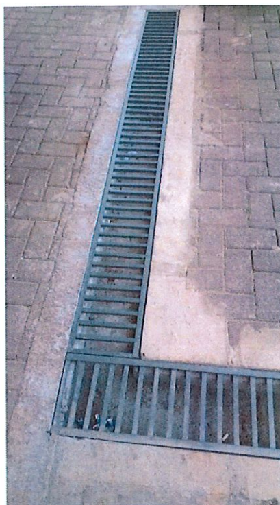
Foto 3: Canaleta de drenagem com grelha
