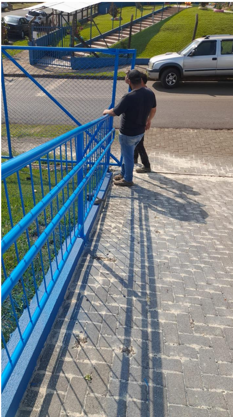
Foto 2: Guarda-corpo e corrimão.
