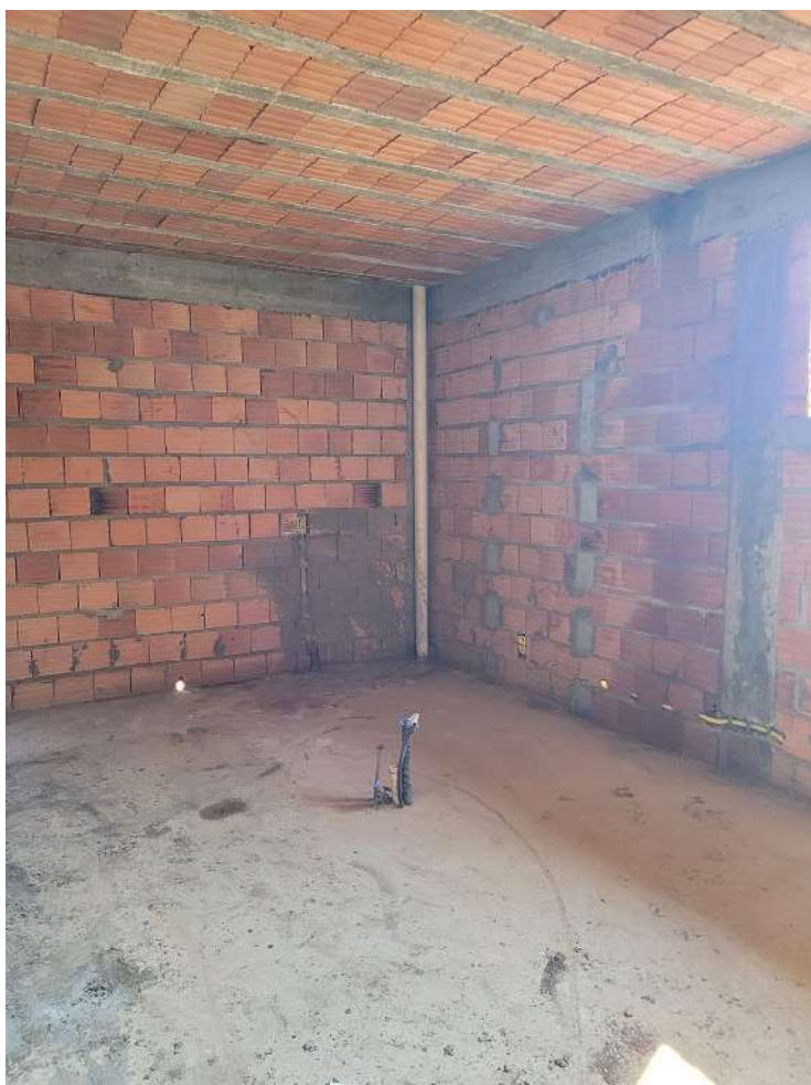
Foto 3: Consultório Odontológico. Tubulações.
