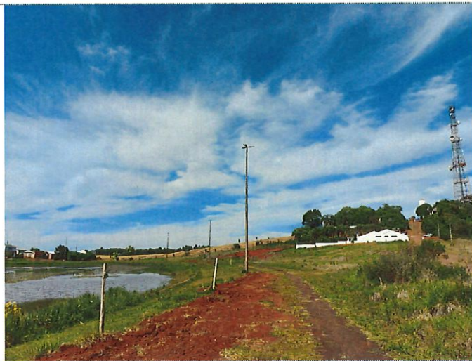
Eletroduto, cabo de cobre flexível e caixas que interligam os postes ao redor do lago
