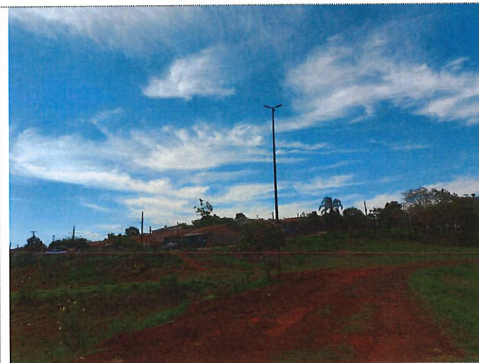
Eletroduto, cabo de cobre flexível e caixas que interligam os postes ao redor do lago
