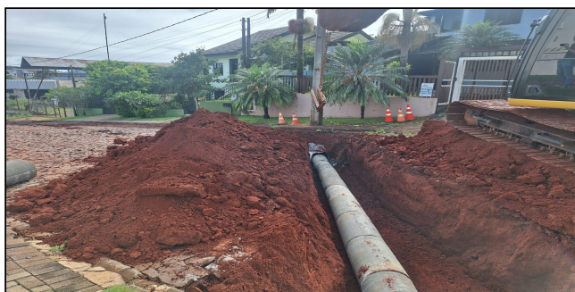
3 | Rede de Drenagem
