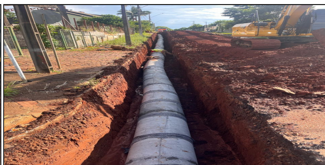
4 | Rede de Drenagem
