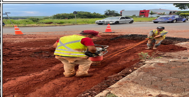
2 | Rede de Drenagem
