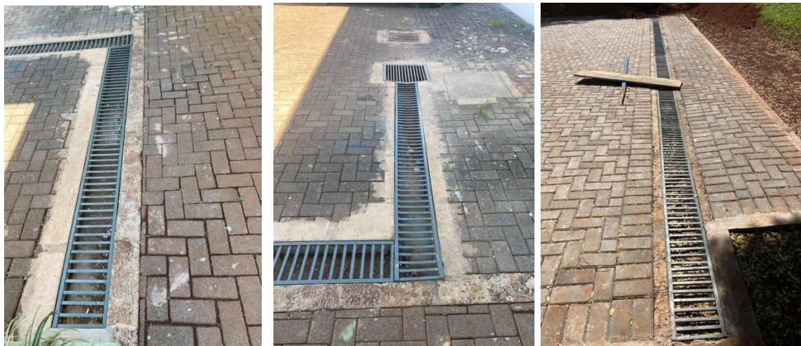
Foto 1: Canaleta de drenagem com grelha
