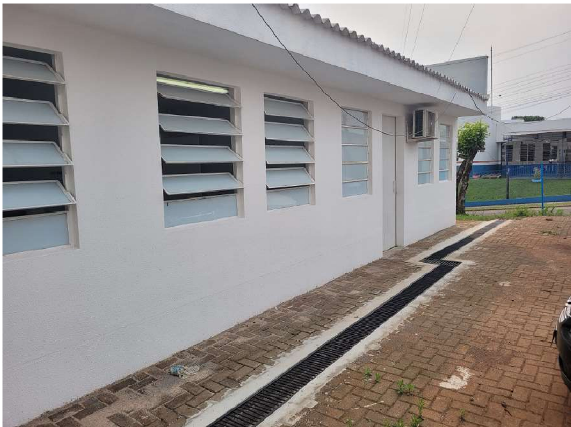
Foto 2: Pintura externa. Canaleta de Drenagem.
