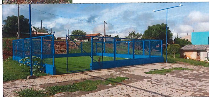
Postes e refletores do playground
