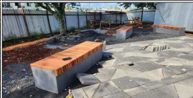
7 | piso permeável, bancos de concreto, instalações elétricas
