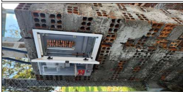
10 | mureta da entrada de energia, quadro de entrada de energia
