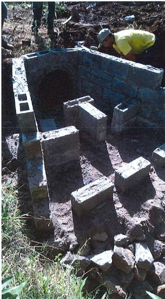
Foto 19: Dissipador de Energia
