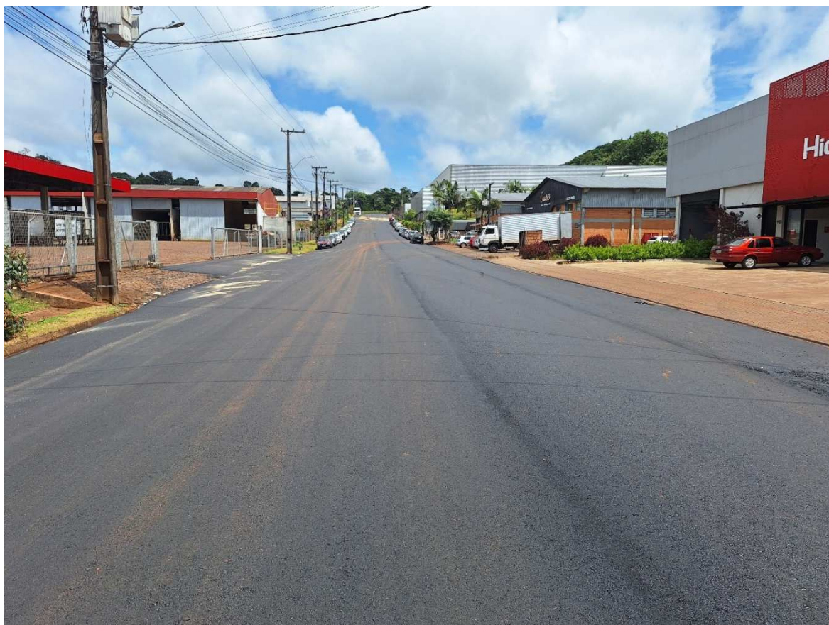
Foto 11: Pavimento Rua Pioneiro Avelino A. Chioquetta.
