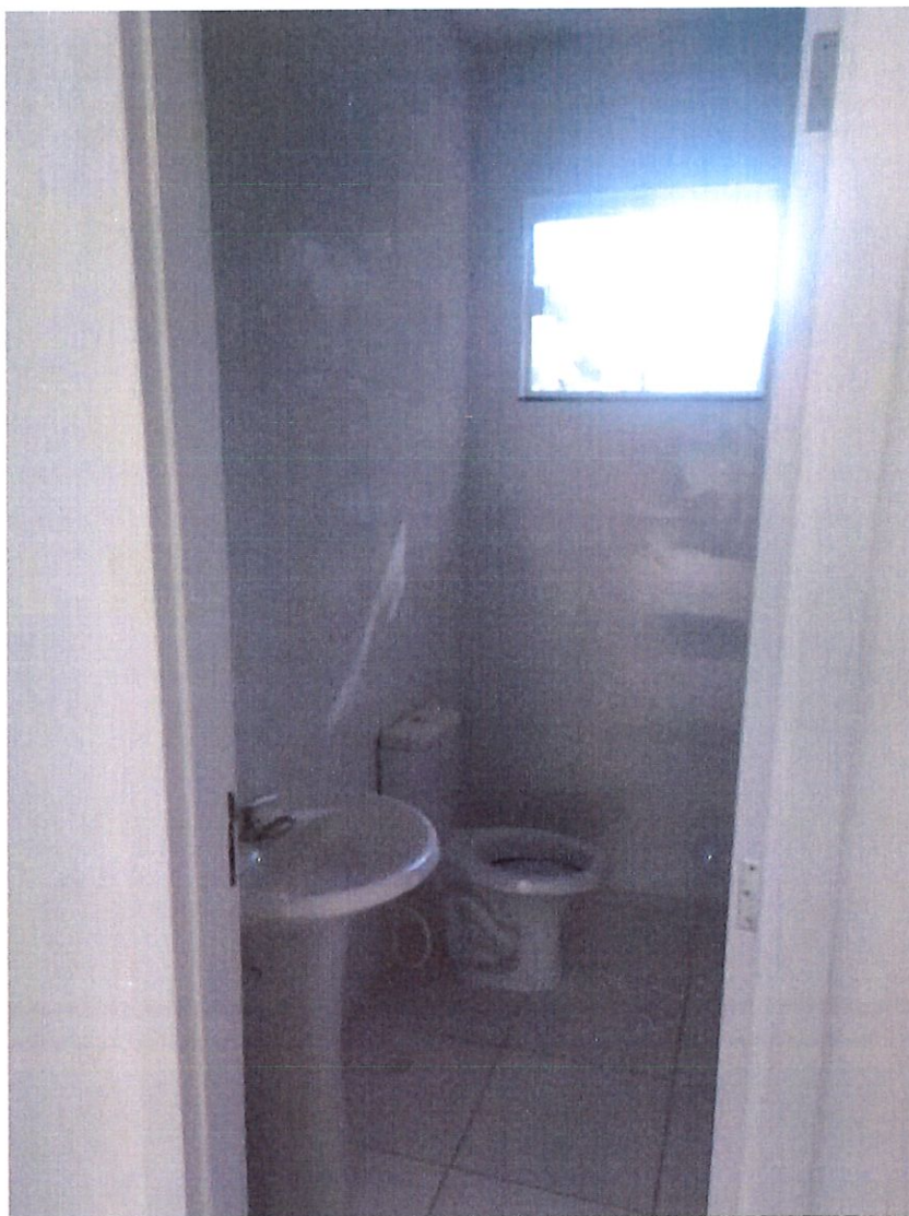
Foto 5: Revestimento cerâmico nos banheiros.
