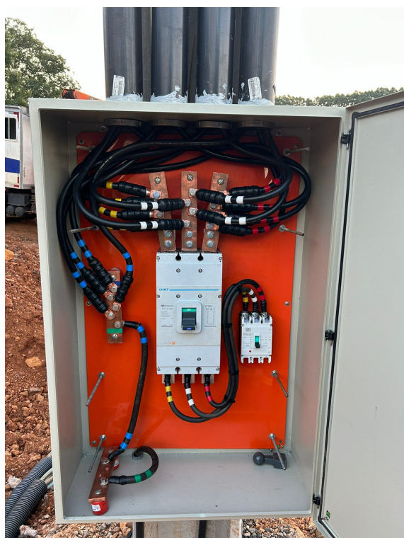
Figura 20: Detalhe Quadro Geral 1600 A – Barramentos e disjuntor NS1250N.
