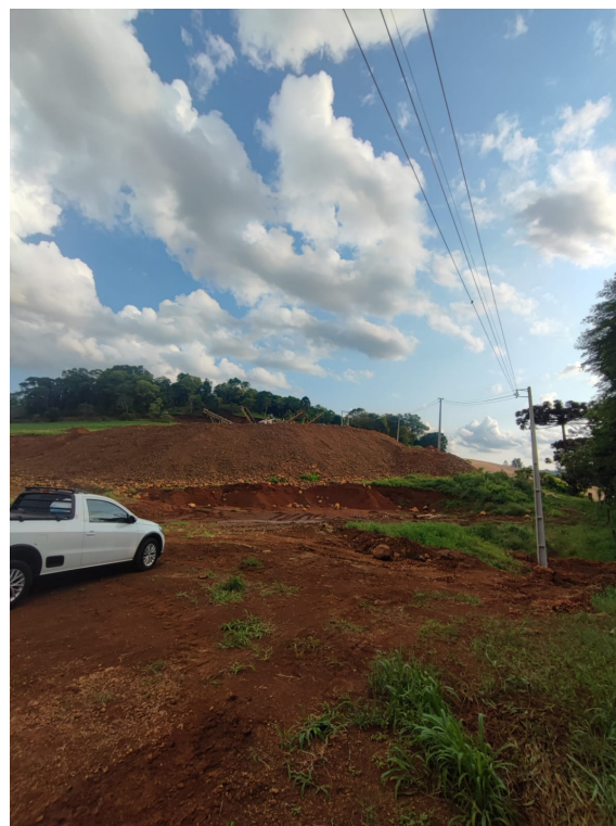
Figura 16: Rede aérea isolada – Poste saída até subestação de 750 KVA. .
