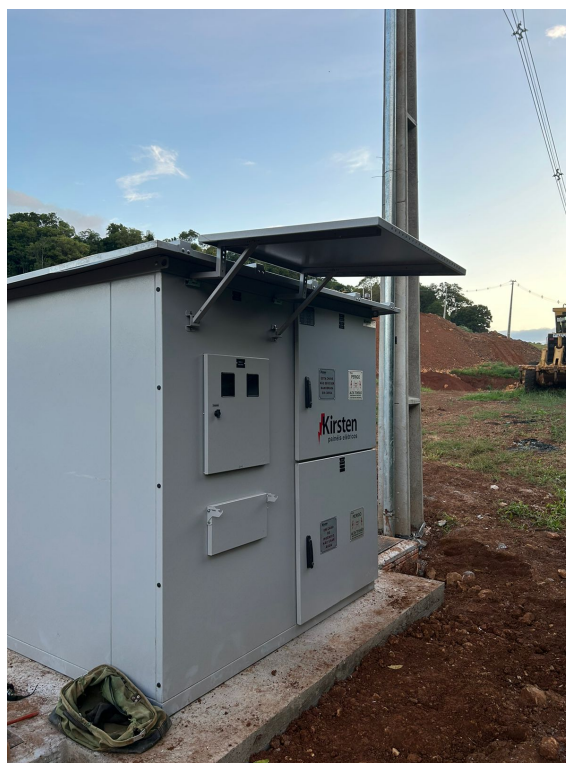
Figura 4 – Cabine primária de medição – Vista frontal.
