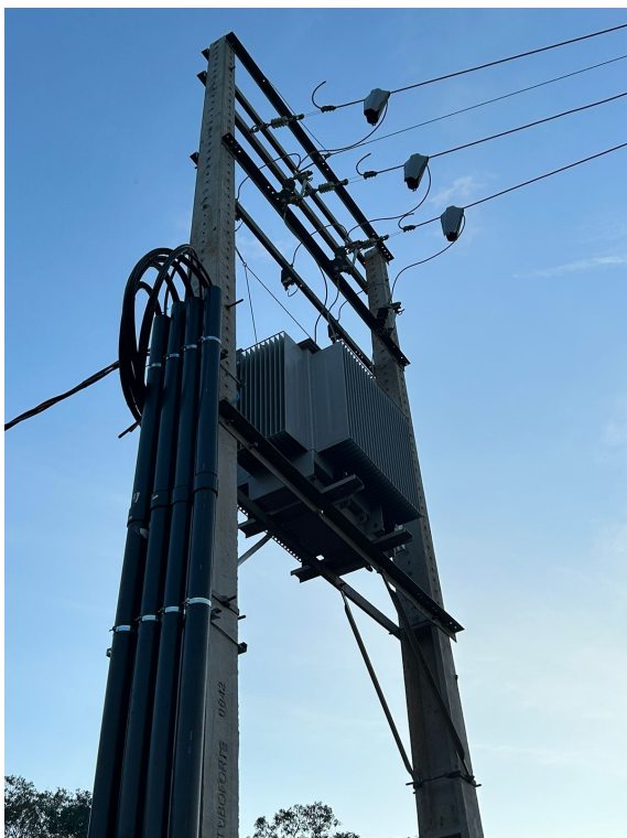
Figura 17: Estrutura para armazenar o transformador.
