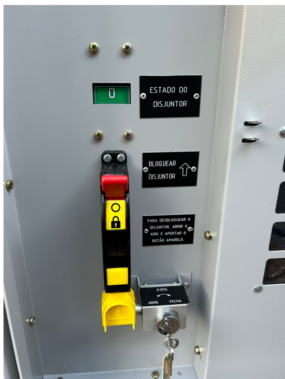
Figura 7 – Detalhe proteção do disjuntor em alta tensão.
