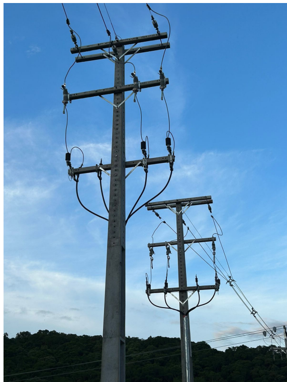
Figura 2 – Poste de Entrada e saída da Medição
