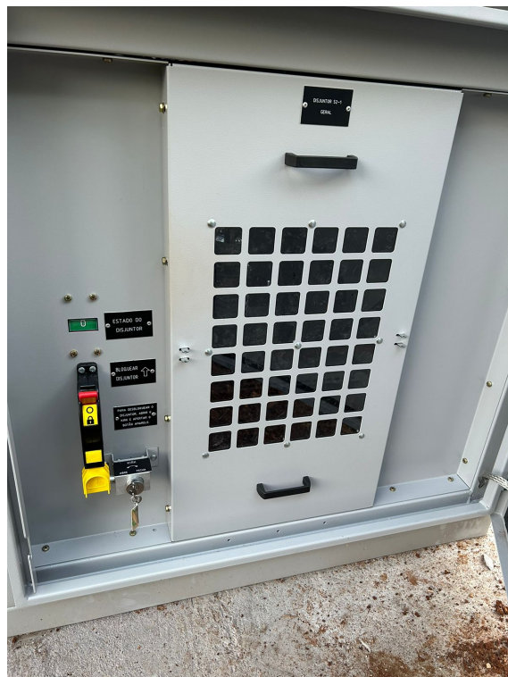
Figura 6 – Visão frontal - disjuntor geral em alta tensão
