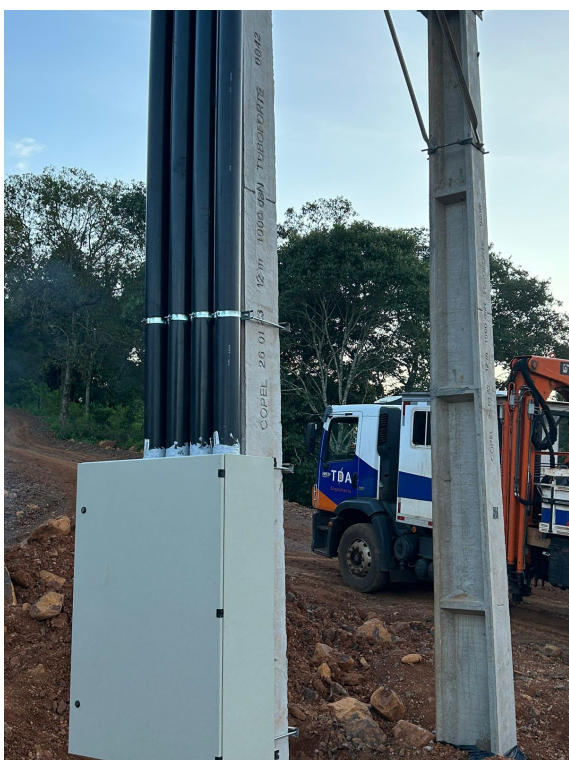
Figura 19: Detalhe saída do transformador e entrada no Quadro Geral 1600 A
