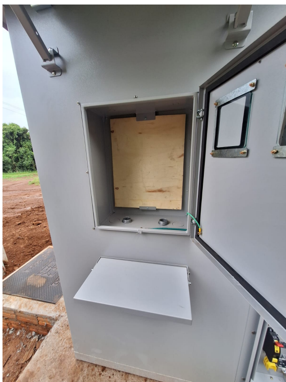
Figura 15: Espaço para instalação do medidor Copel.
