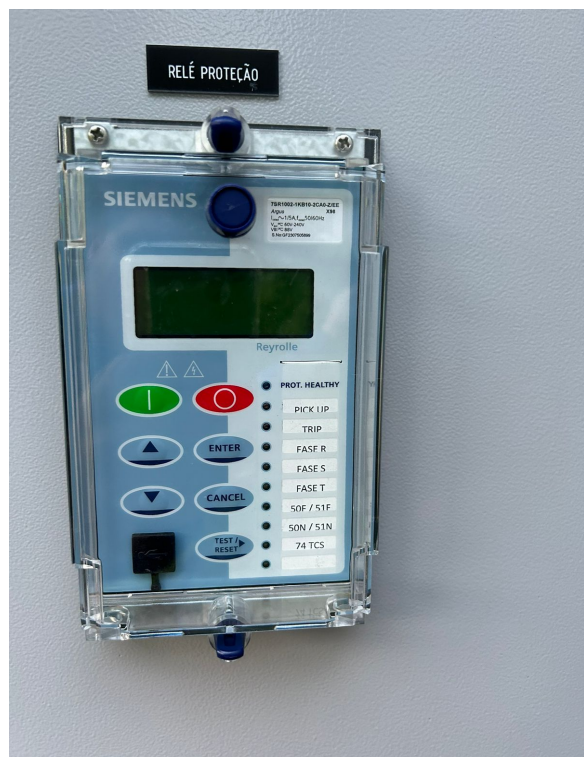
Figura 11 – Relé de proteção da chave seccionadora.
