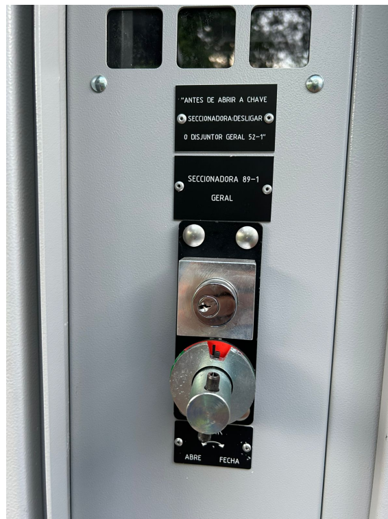
Figura 12: Acionamento – Chave seccionadora.
