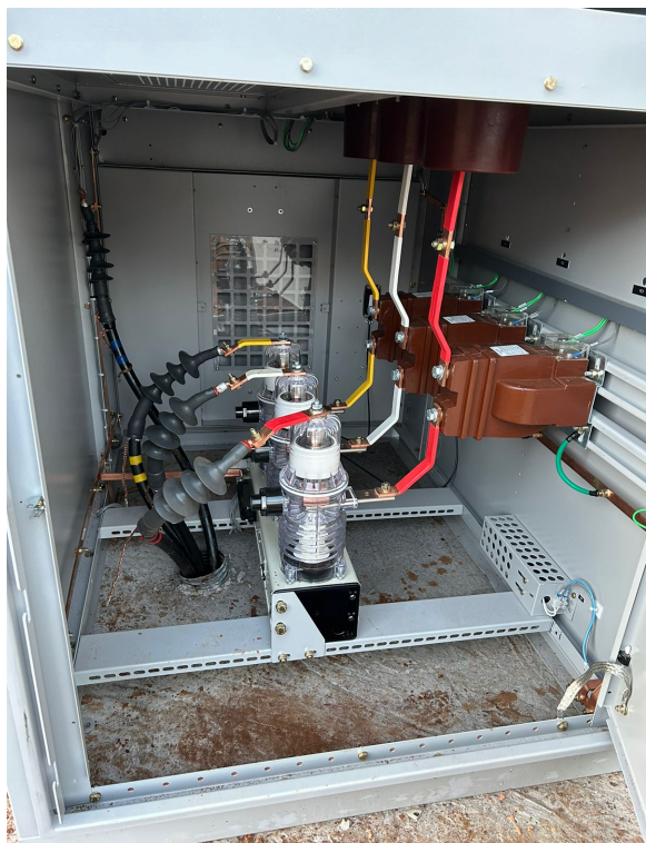
Figura 5 – Visão posterior - disjuntor geral em alta tensão.
