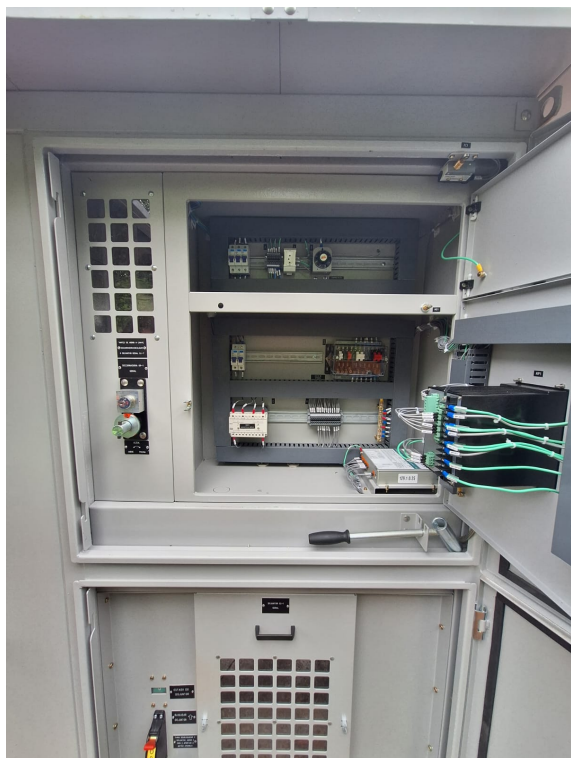
Figura 13: Quadro elétrico – Chave Seccionadora.
