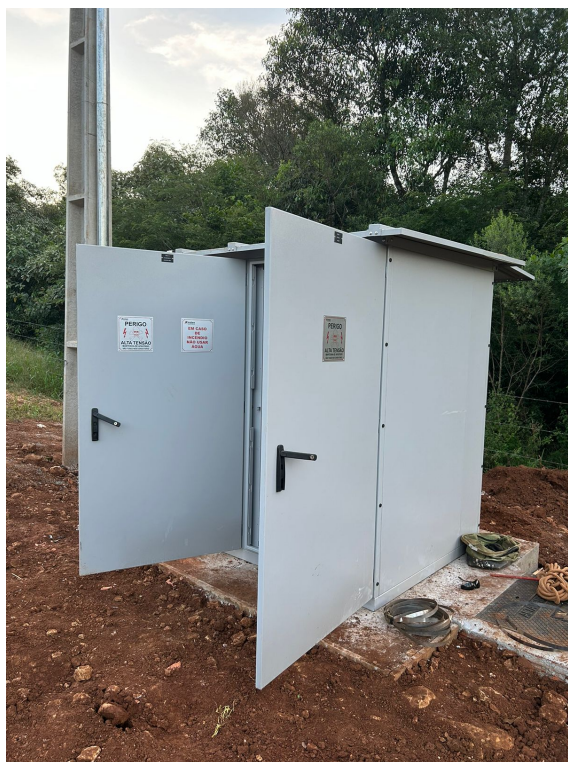
Figura 3 – Cabine primária de medição – Vista Posterior.
