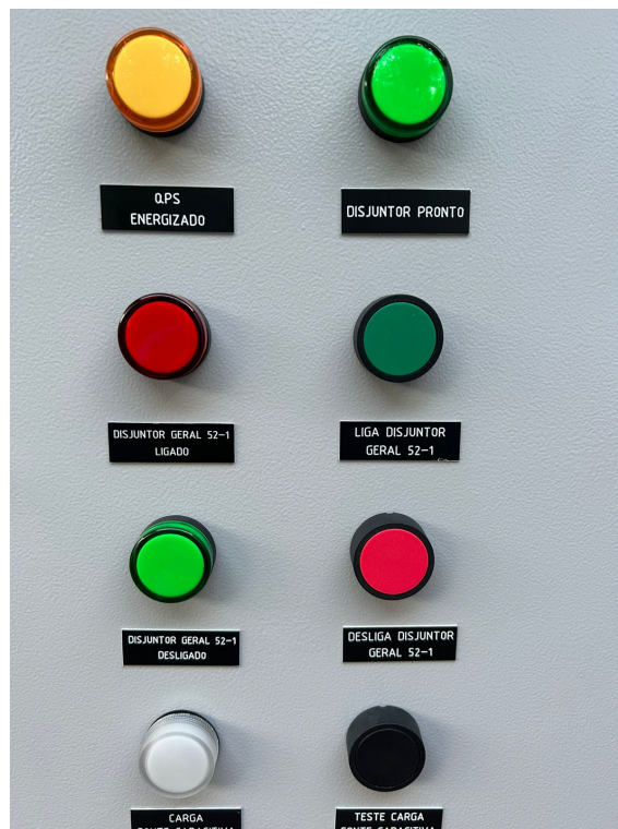
Figura 10 – Detalhe comandos da chave seccionadora.
