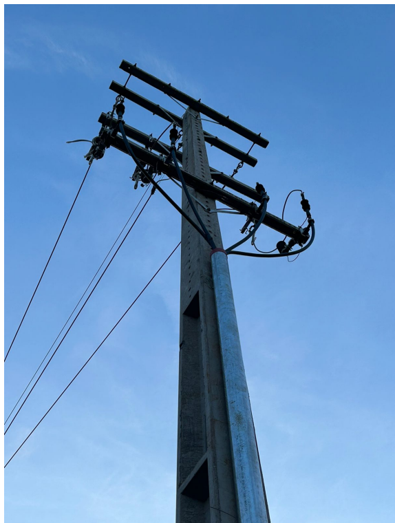
Figura 1 – Poste de Entrada da Medição.
