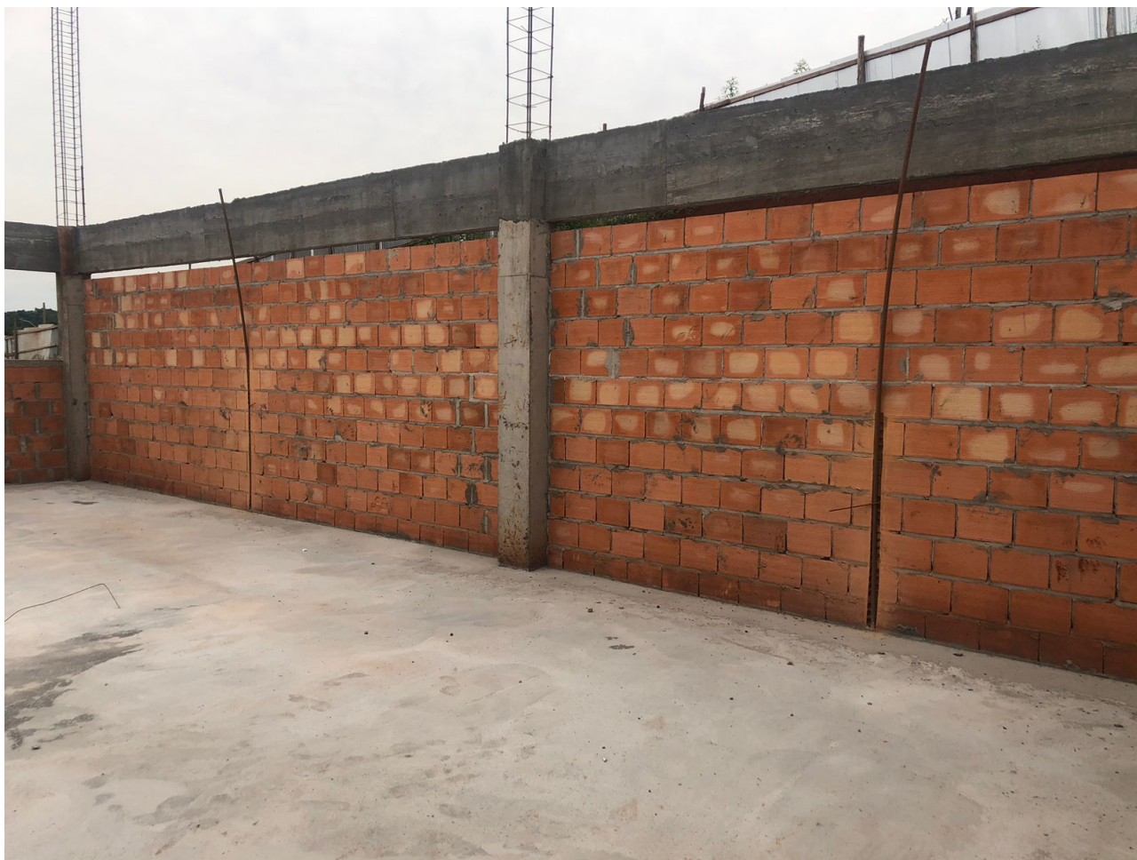
Foto 12: Drenos Ar Condicionado. Vigas, piso e alvenaria.
