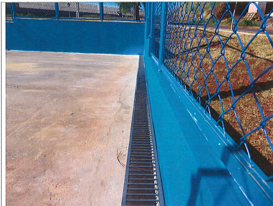
Canaleta de concreto e grelha de ferro – playground.
