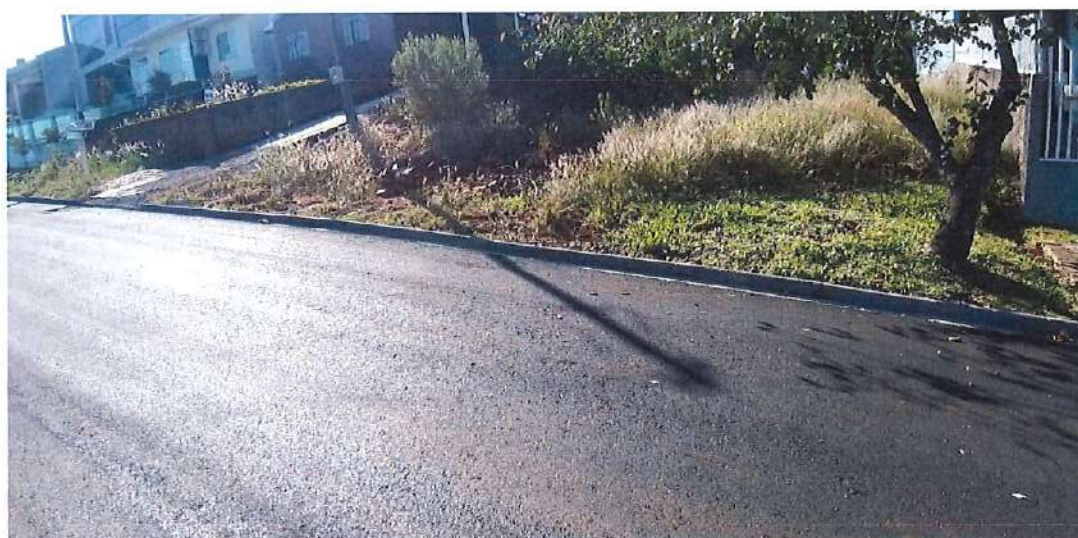
Foto 44: Rua Melci Dal Molin – meio fio
