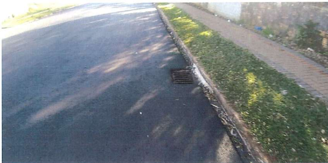
Foto 58: Rua José Fraron – drenagem
