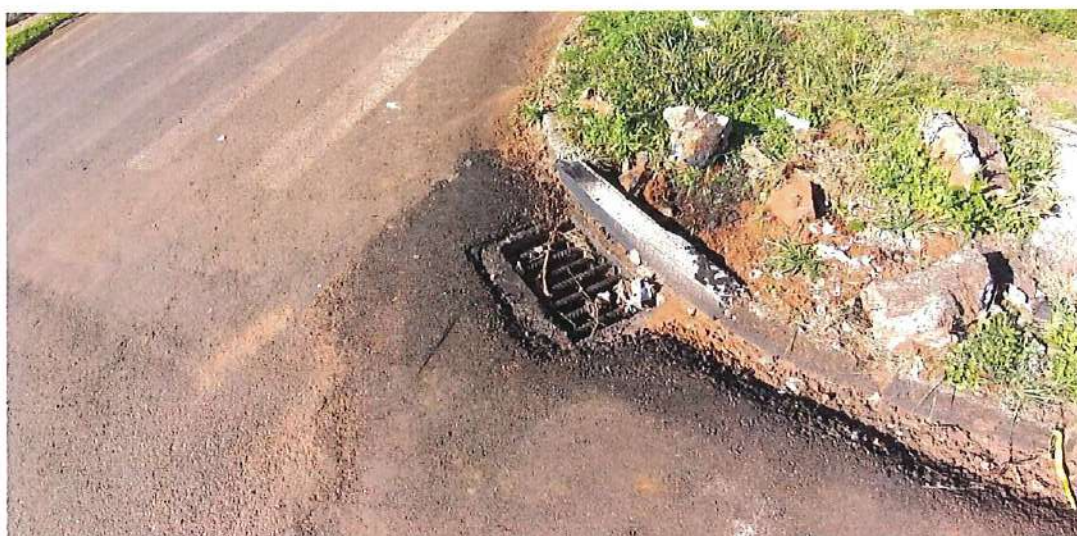
Foto 11: Rua Papa João XXIII – drenagem
