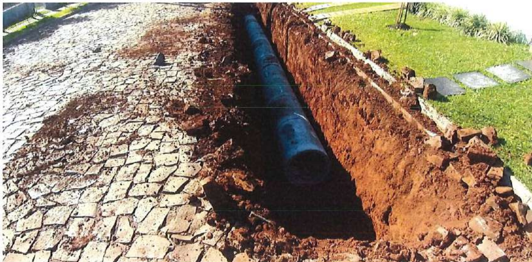
Foto 67: Rua Theóphilo Petrycoski – drenagem
