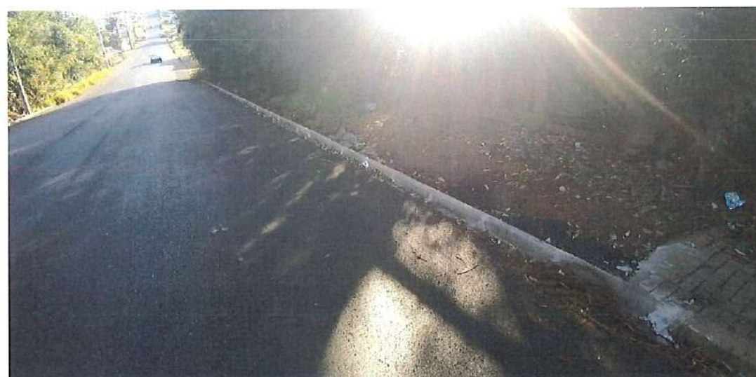
Foto 57: Rua José Fraron – meio fio
