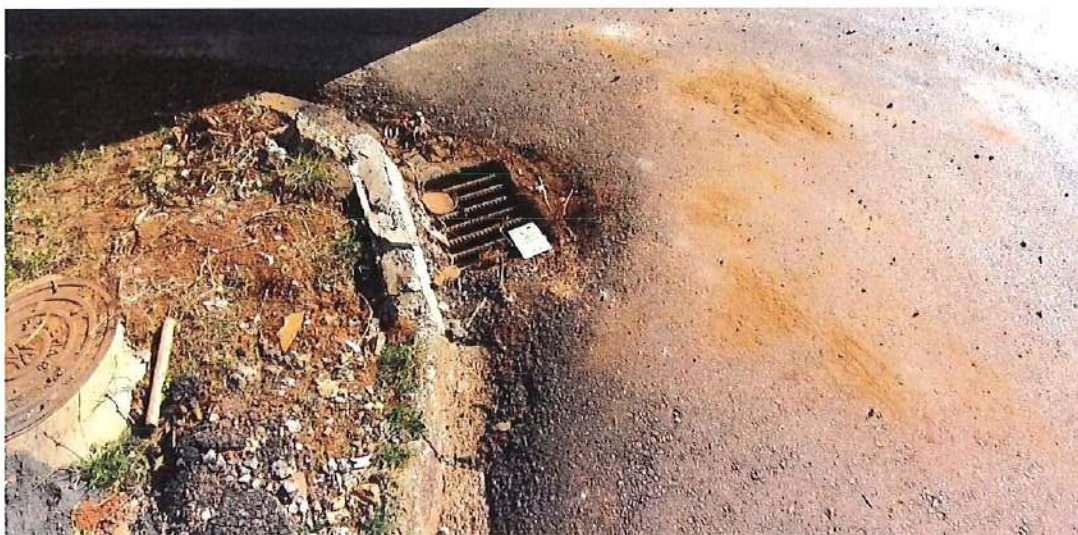
Foto 07: Rua da República - drenagem
