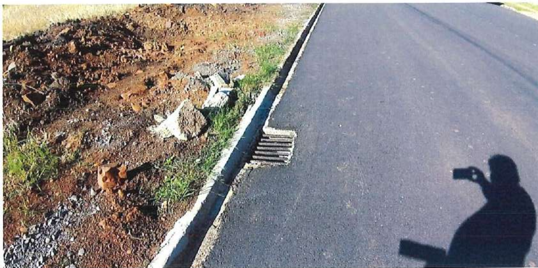
Foto 28: Rua Vieira da Costa – meio fio e drenagem
