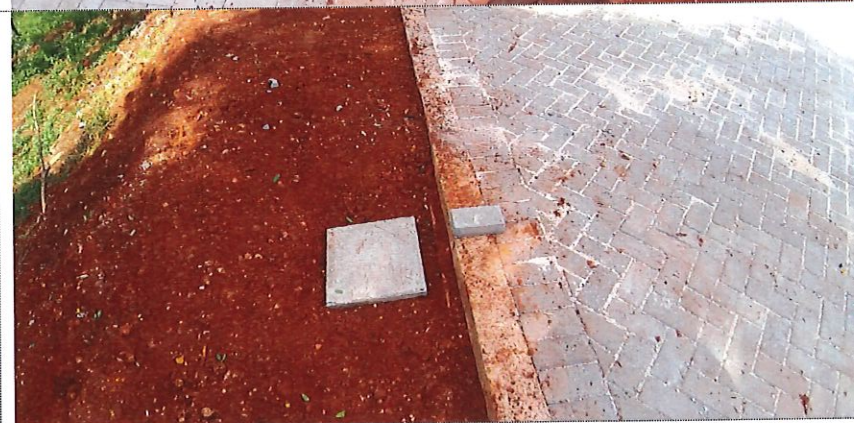
Eletroduto e caixa de passagem
