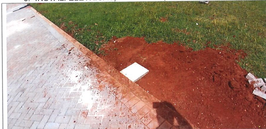
Eletroduto e caixa de passagem
