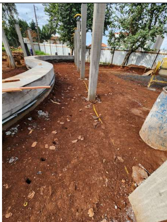
F13: ELETRODUTOS PARA INSTALAÇÕES ELÉTRICAS
