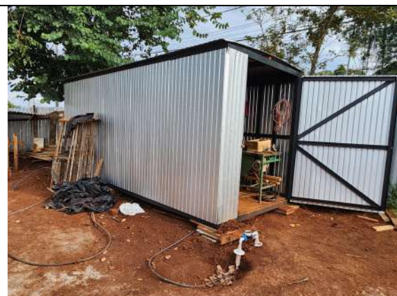
F10: ENTRADA DE ÁGUA, CONTAINER
