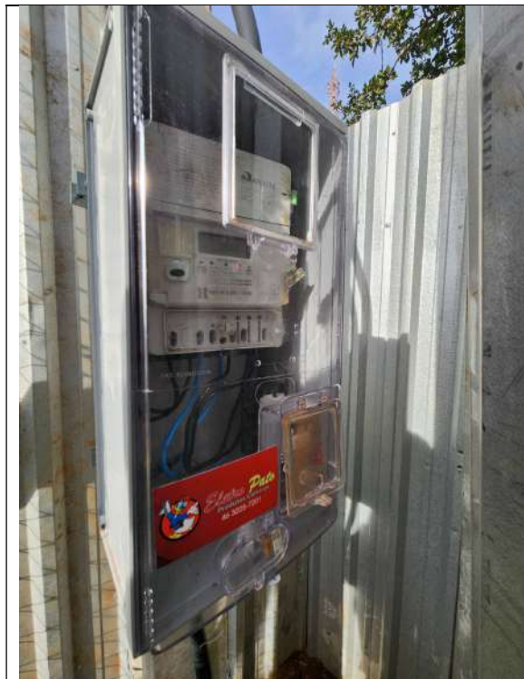
F4: MEDIDOR DE ENTRADA DE ENERGIA
