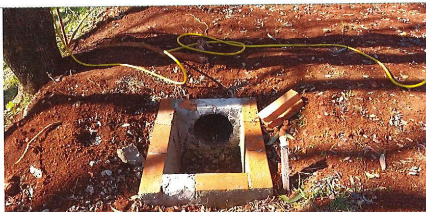
Tubos de água pluvial e caixas de passagem
