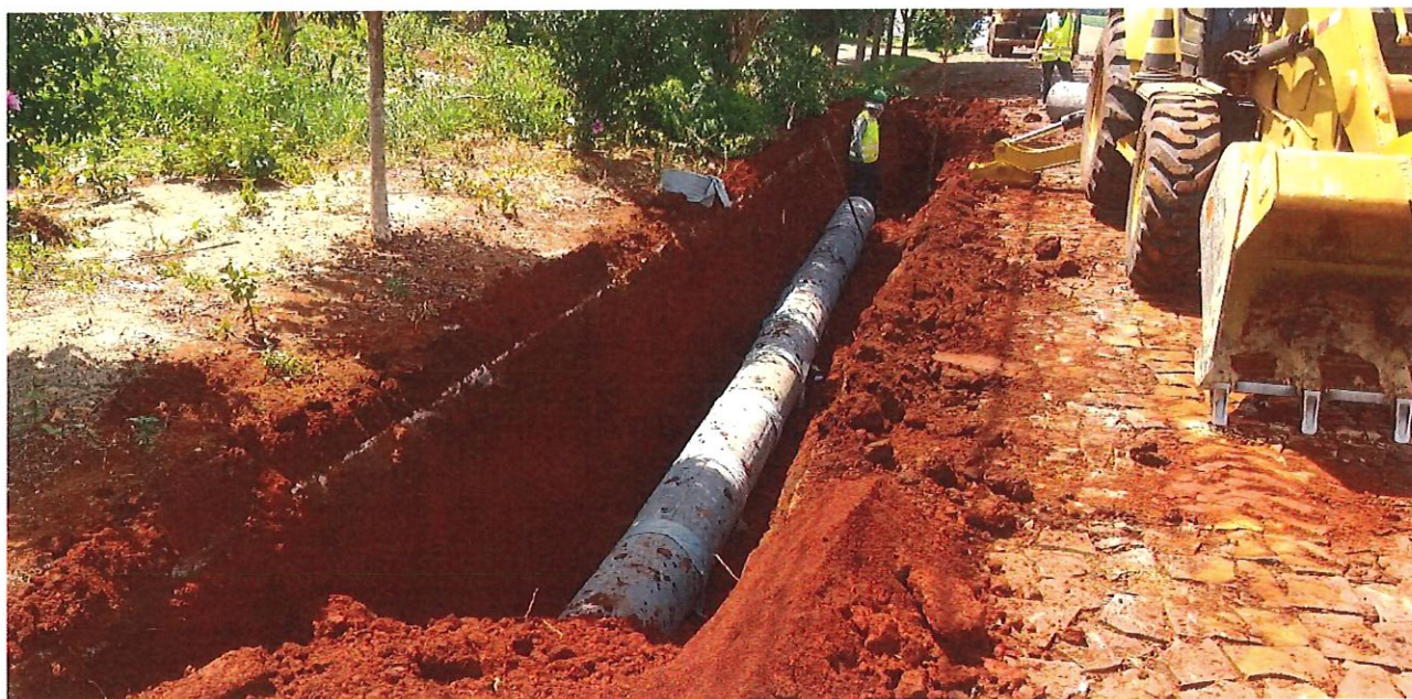
Foto 02: Rede de drenagem Rua Vitélio Parzianello.
