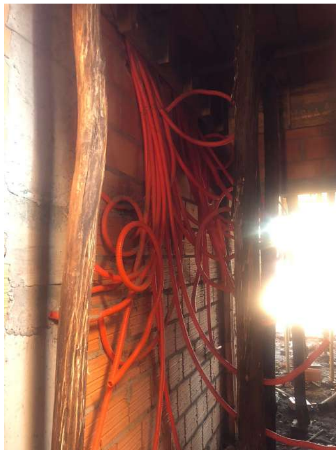
Foto 4: Eletrodutos (instalações elétricas).
