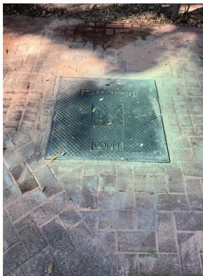
Figura 12 – Detalhe Caixa de Passagem tampa Copel
