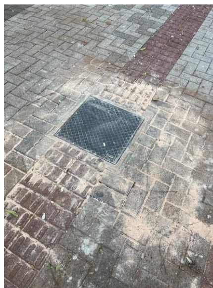
Figura 10 – Detalhe Caixa de Passagem
