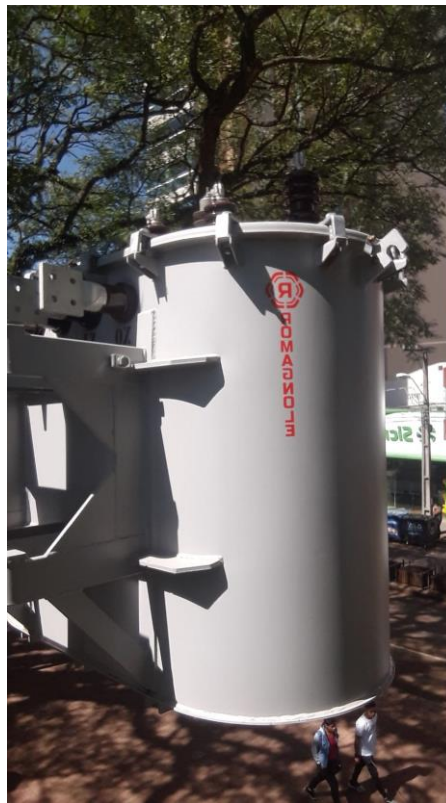
Figura 8 – Detalhe do Transformador
