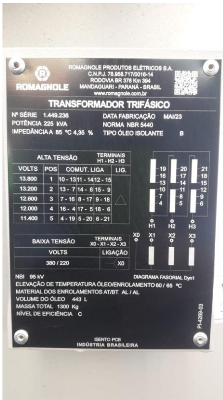
Figura 7 – Placa do Transformador
