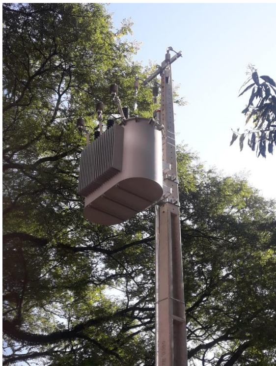
Figura 4 – Detalhe das buchas, para-raios, cruzeta, suporte do transformador e parafusos.
