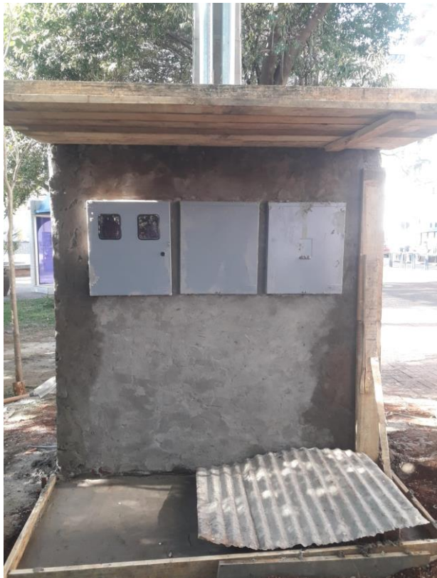
Figura 1 – Mureta com caixas de medição e proteção.
