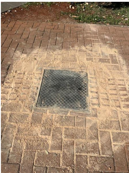
Figura 9 – Detalhe Caixa de Passagem
