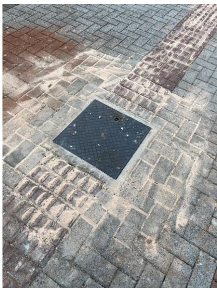
Figura 11 – Detalhe Caixa de Passagem
