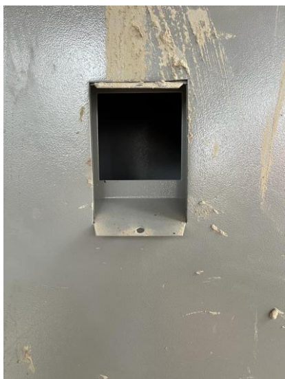
Figura 6 – Detalhe da caixa de proteção sem o disjuntor.
