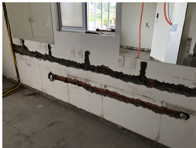
Foto 4: Pontos de hidráulica e elétrica.
