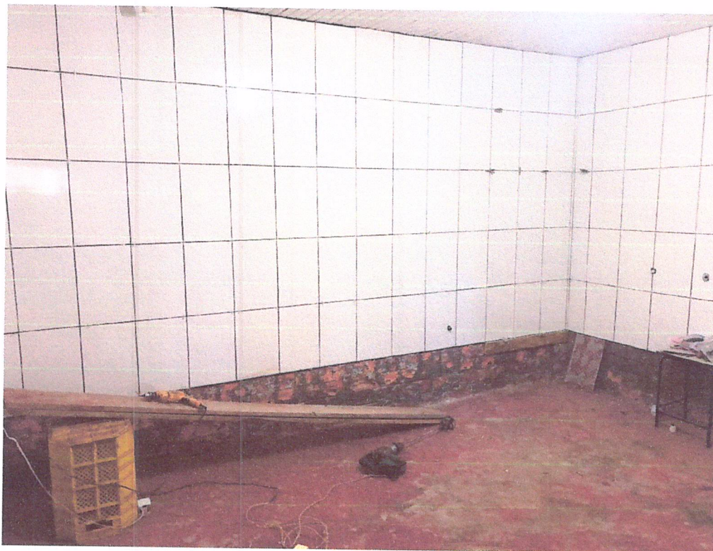
Foto 07: Revestimento Cerâmico Brinquedota
